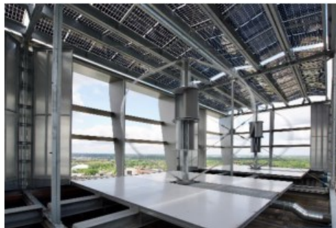
detail van het windenergiesysteem
