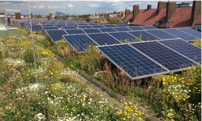
6. Natuurdak gecombineerd met zonnepanelen
